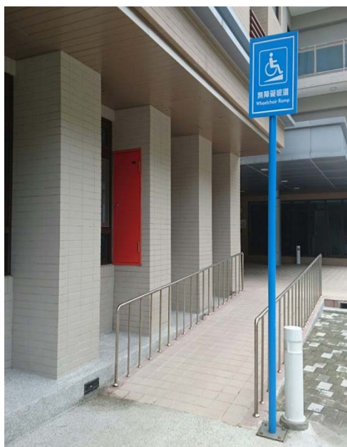
保持斜坡道暢通
